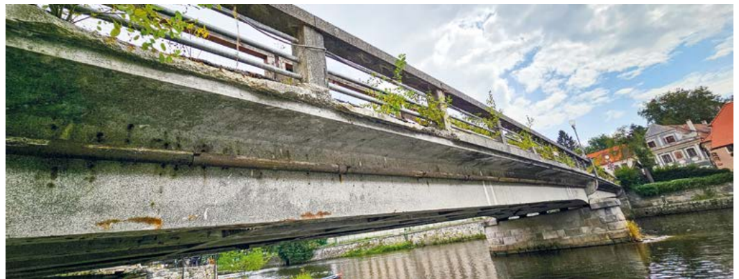
Most čeká kompletní rekonstrukce, která potrvá půl roku.
